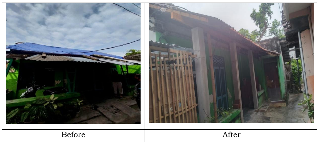
Gambar 5. Rehabilitasi Rumah akibat Hujan Deras disertai Angin di Kel. Kepanjenkidul
