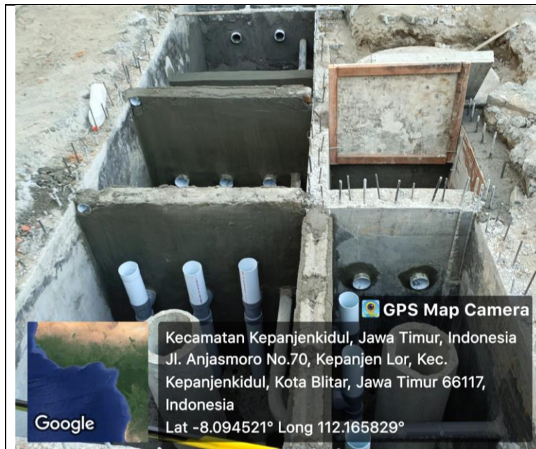
Gambar 3.3.7 Instalasi tangki septik komunal
